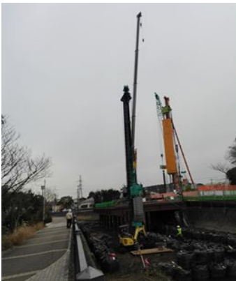
(問題のクレーン)
