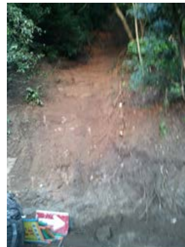
台風15号崩落時
