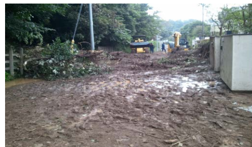
対面の住宅地状況(土砂整理後)
