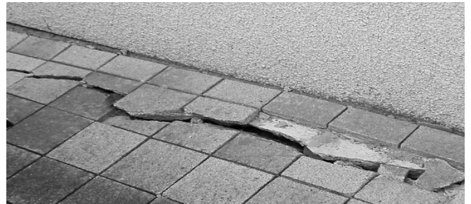
(地盤沈下によるタイル破損、栄区公会堂)
