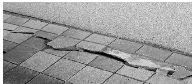
地盤沈下によるタイル破損
