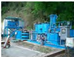
濁水処理装置
