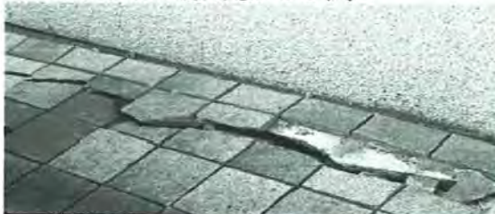
地盤沈下によるタイル破損
