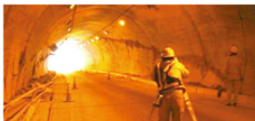
写真-1 木沢トンネルの地震被害
