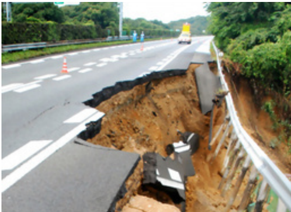
(東名上り線、道路崩落現場)
