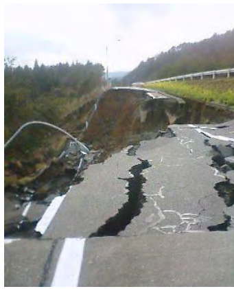
写真は国交省資料より。 能登有料道路盛土部の 地盤崩壊を示している。
